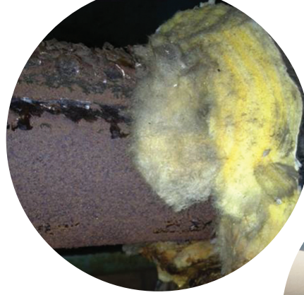
INITIAL CUI DAMAGE
